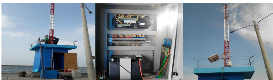
Instalasi AWS Pelabuhan Sabang
